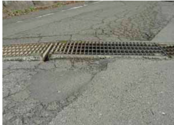
グレーチング(鉄蓋)のガタつき
