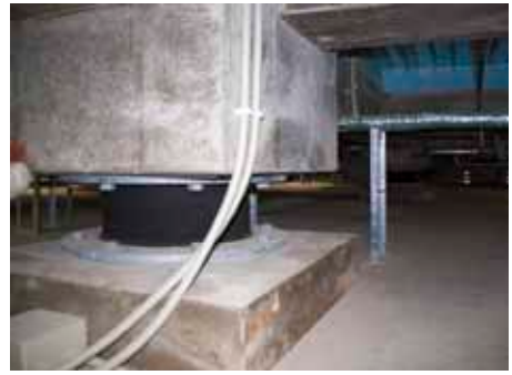
阿蘇医療センター地下に設置されている免震装置
